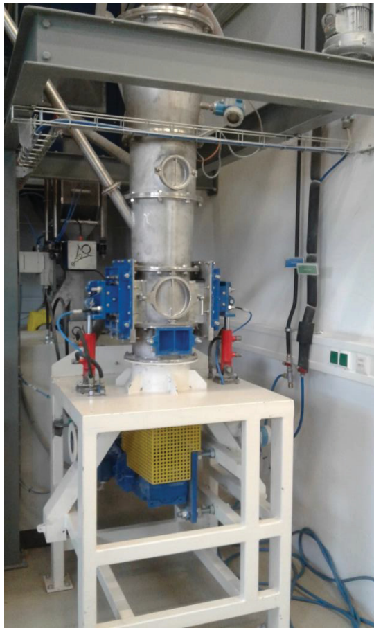
Abb. 40: Blick auf die Cemtec-Vertikalmühle VRM2 AV
