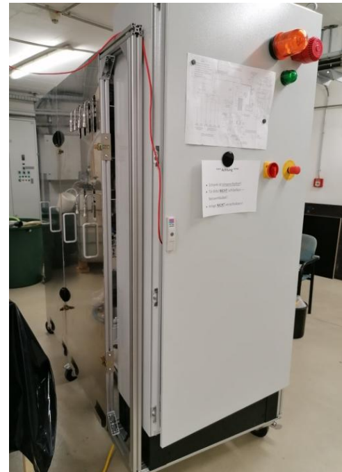
Abbildung 7: Rückseite der Anlage, sowie der Schaltschrank mit Signalleuchten, Sirene, Hauptschalter und Not-Aus-Schalter
