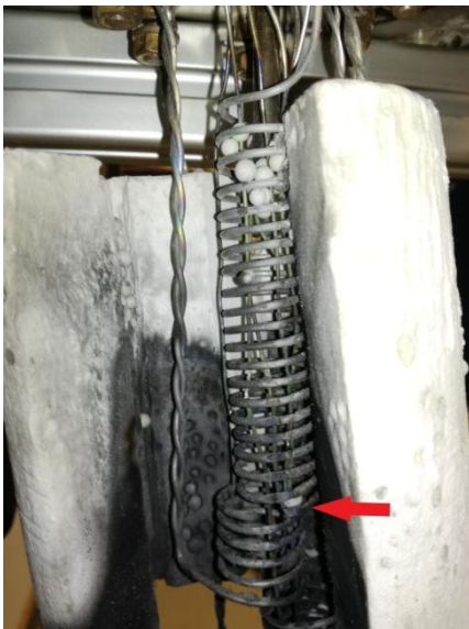
Abbildung 42: Gebrochene Heizspirale und starke Verkokungen bei Versuchen mit dem ersten Konzept der Reaktorheizung
