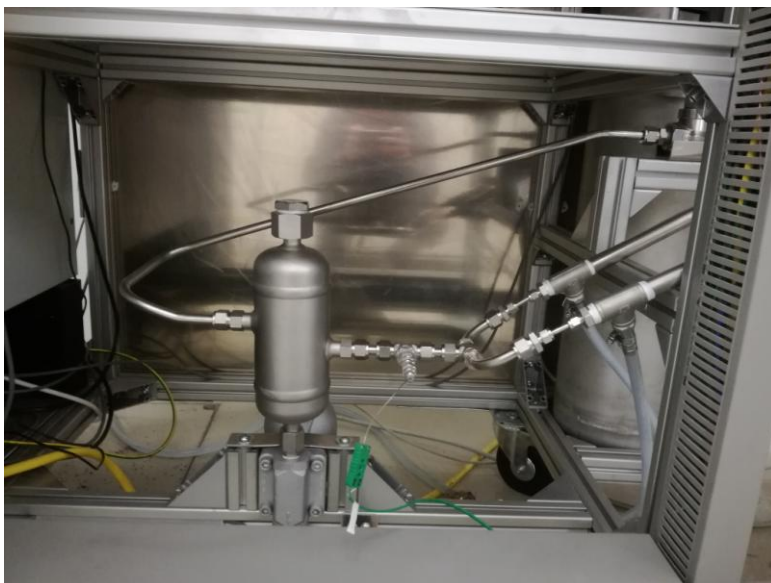
Abbildung 23: Der Kondenswassersammler mit der schrägen Zu- und Ableitung; der obere Anschweißstutzen dient zur Installation des O 2 -Sensors
