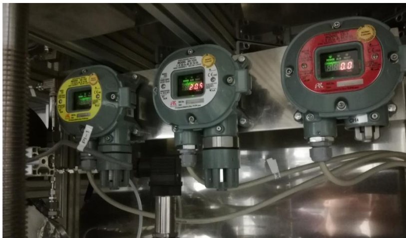
Abbildung 31: Gaswarndetektoren für CO, O 2 und CH 4 bzw. H 2 (v.l.n.r.)
