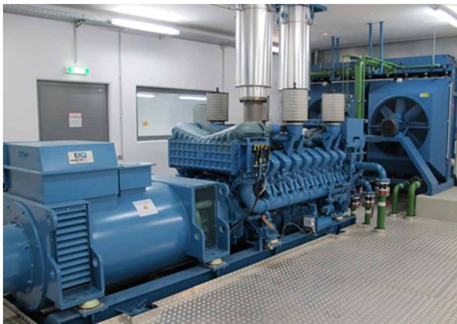
Abbildung 3-2: 16 Zylinder-Notstromdieselgenerator mit einer elektrischen Maximalleistung von 2.050 kW. (Quelle: Takeda).
