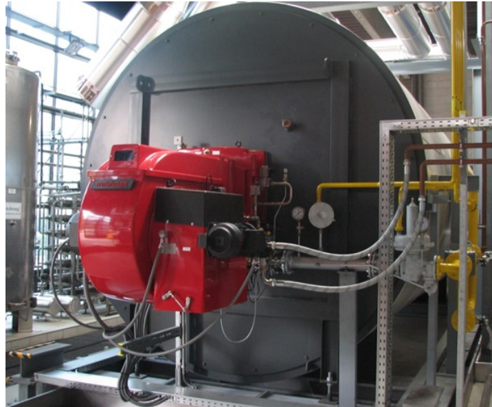
Abbildung 3-4: Mit 8 MW Leistung, größter Brenner der Energiezentrale am Werksgelände. (Quelle: Takeda.)
