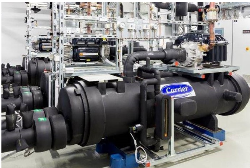
Abbildung 3-5: Größter Kälteanlagenverbund am Standort. (Quelle: Takeda.)
