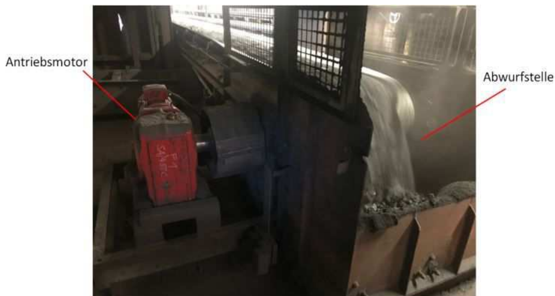
Abbildung 23: Antriebsmotor Bereich Abwurfstelle
