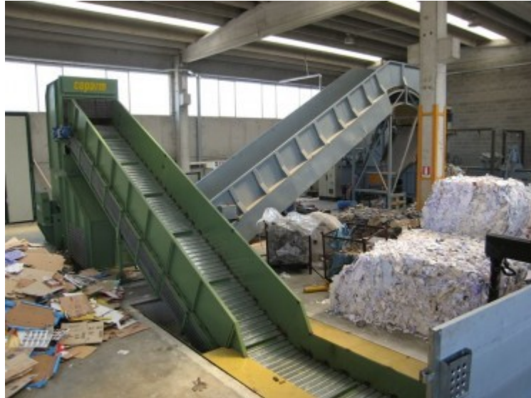
Abbildung 24 Kettenförderanlagen Quelle: Coparm
