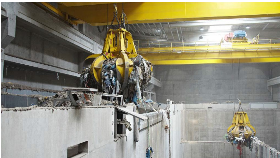
Abbildung 45 Überwachung Müllbunker Quelle: Rosenbauer
