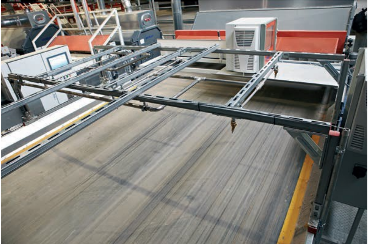
Abbildung 49 Gurtförderer mit Löschanlage Quelle: Rosenbauer
