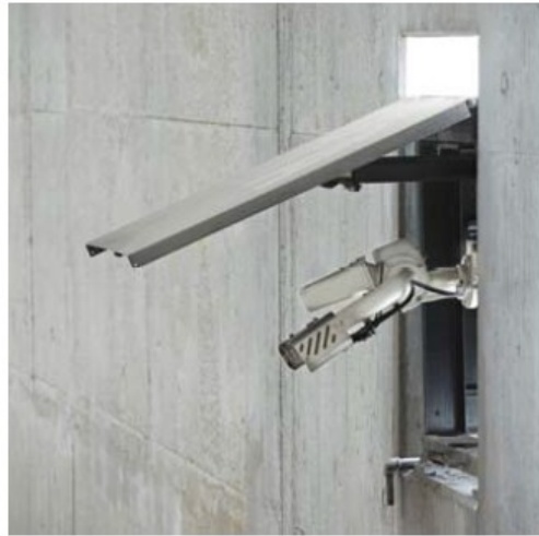
Abbildung 46 Geschützter Löschmoditor in Bunker Quelle: Rosenbauer
