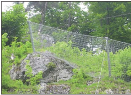
Abb1: flexible Schutzverbauung gegen Steinschlag Fig1: flexible rock fall protection kit
