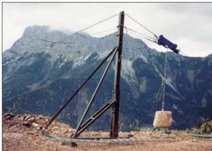
Abb2: Bergmast der Seilbahn und Laufwagen Fig2: top station of the ropeway and carriage
