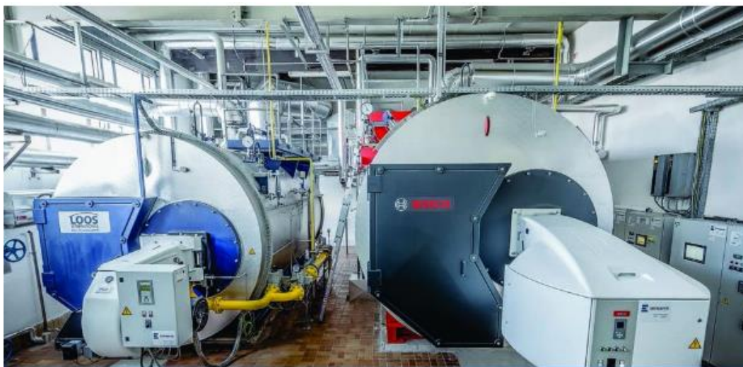
Abbildung 5.3 Kesselanlagen zur Prozessdampfgenerierung [22]
