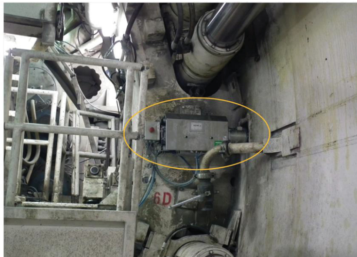
Abbildung 27: Schild-TBM: Einsatz eines Impakthammers (gelb markiert) mittels Anbaukonsole (aus [23])
