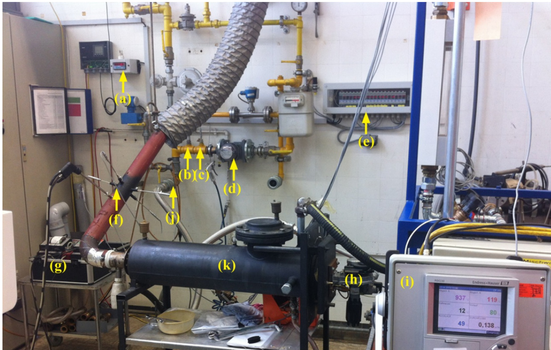
(a) Anzeige des Gasvolumenstroms (b) Messung der Gastemperatur \vartheta_G (c) Messung des Gasdrucks p_G (d) Drehkolbengaszähler, \dot{V} (e) Digitalanzeige (f) O_2 -Fühler \phi_{O_2} (g) Abgas-Analyse-Computer (h) Gebläse (i) Messschreiber \vartheta_E , \vartheta_A , \vartheta_{VL} , \vartheta_{RL} (j) Gasleitung (k) Doppelrohrwärmeübertrager
