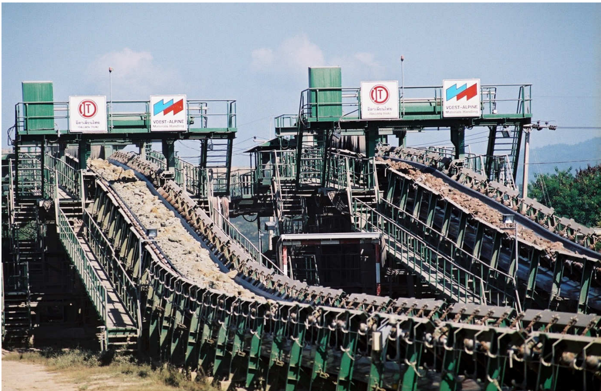
Abbildung 123: Ähnliche Anlage in Thailand (Mae Moh V)
