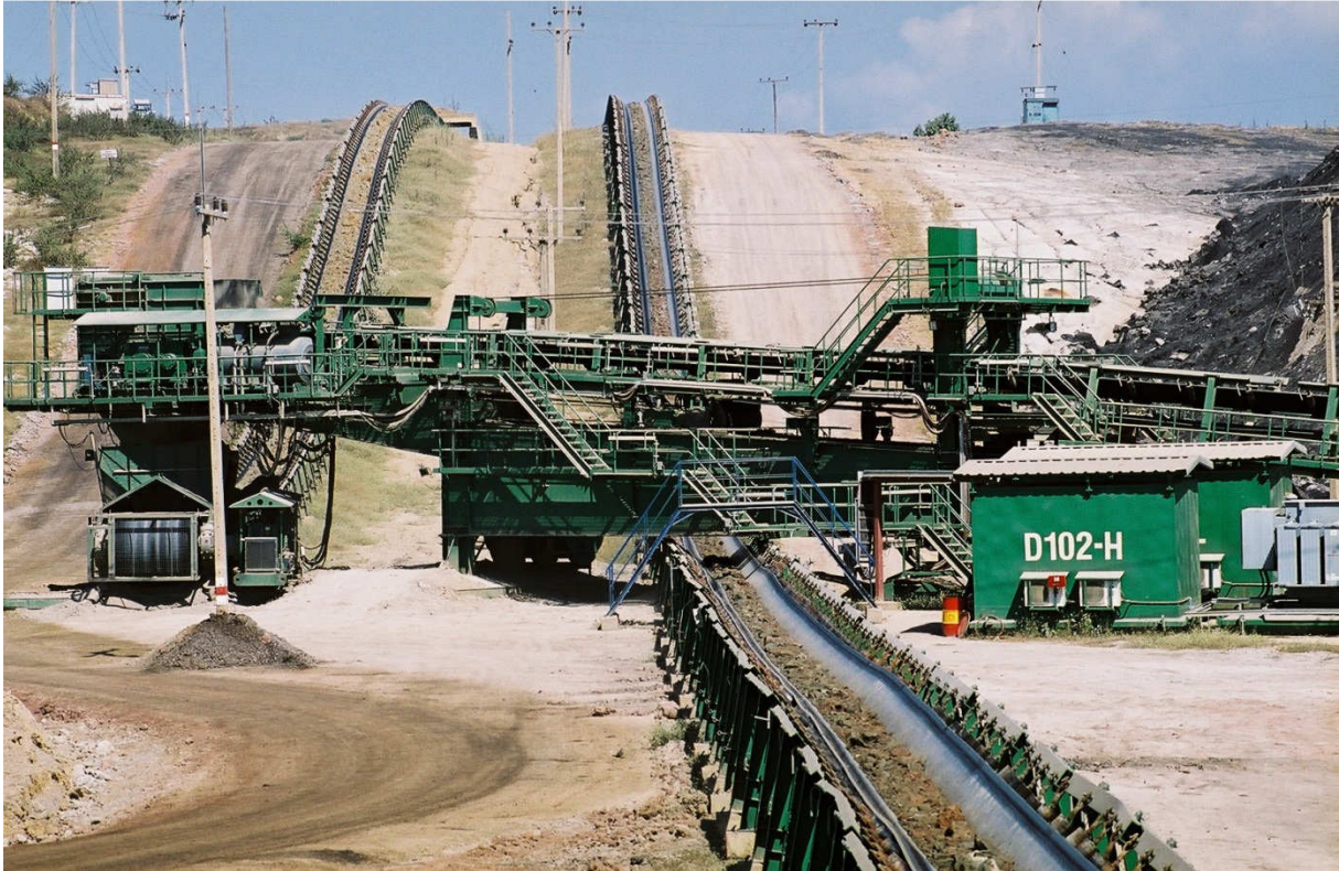
Abbildung 122: Ähnliche Anlage in Thailand (Mae Moh V)
