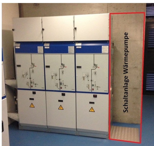
Abbildung 47: Schaltanlage Wasserkraftwerk Rott
