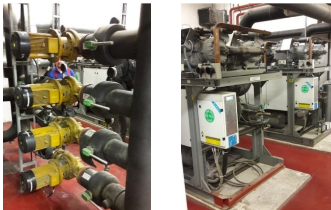
Abbildung 32: redundant ausgeführte Nebenkühlkreisumpen (li.) und Kältemaschinen (re., außer Betrieb)
