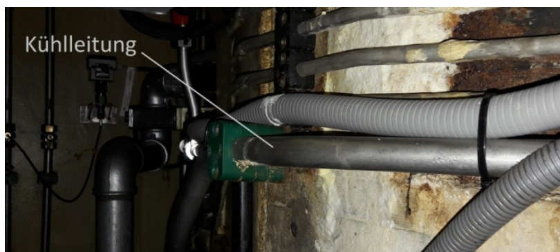
Abbildung 39: Kühlwasserleitung Wasserkraftwerk Hallein
