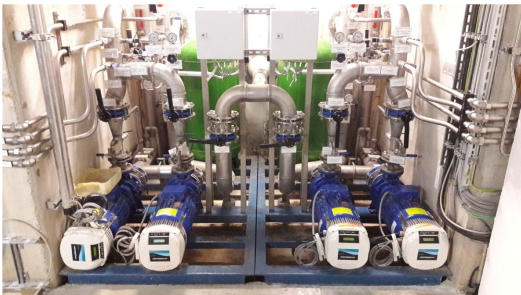
Abbildung 44: Umwälzpumpen Kühlkreislauf Wasserkraftwerk Lehen
