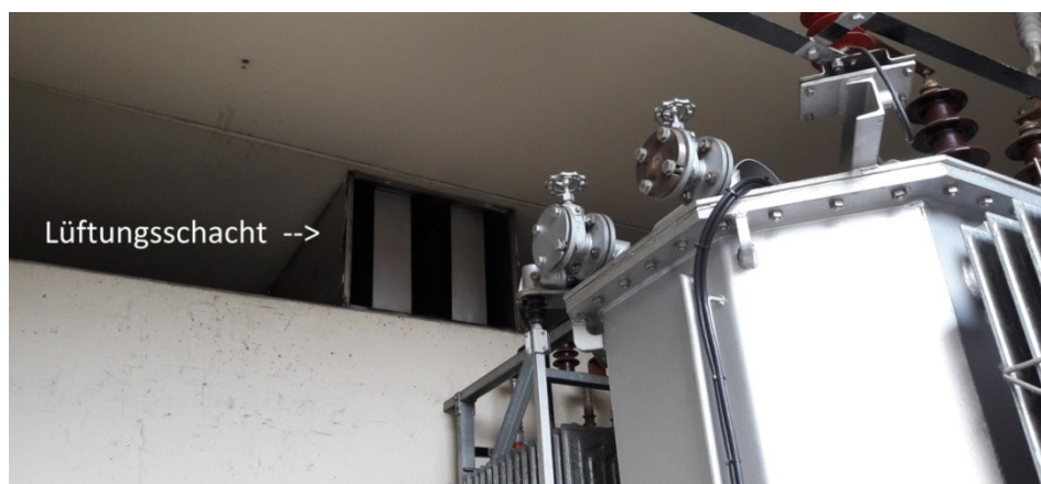
Abbildung 40: Trafokühlung Wasserkraftwerk Hallein
