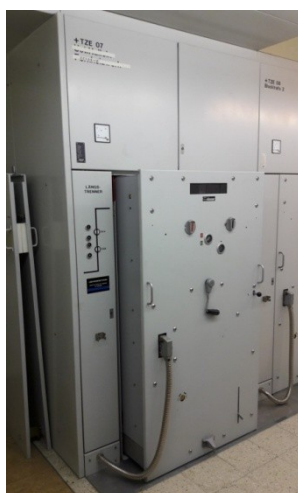
Abbildung 42: Reserveschaltanlage Wasserkraftwerk Hallein
