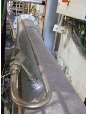
(a) Pitotrohr (Staurohr) Durchflussmessung
