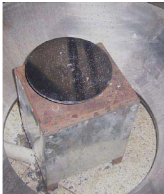
(c) Innenansicht Granulatorraum Drehteller
