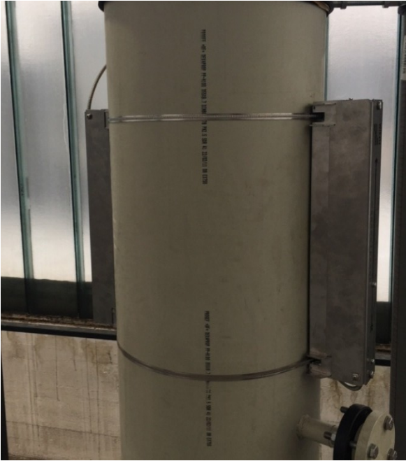
Abbildung 44: Flexim-Sensoren im oberen Abschnitt der Abluftleitung
