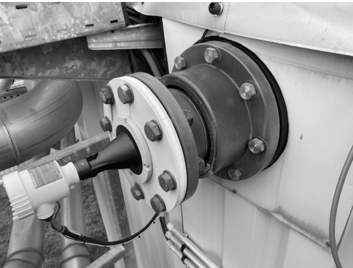
Abb. 2: Abnutzung an Schrauben durch Korrosion. Foto: Autor)
