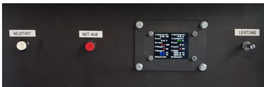
Abbildung 31: Fotografie des neuen Bedienpanels der Induktionsschmelzanlage InduMelt .
