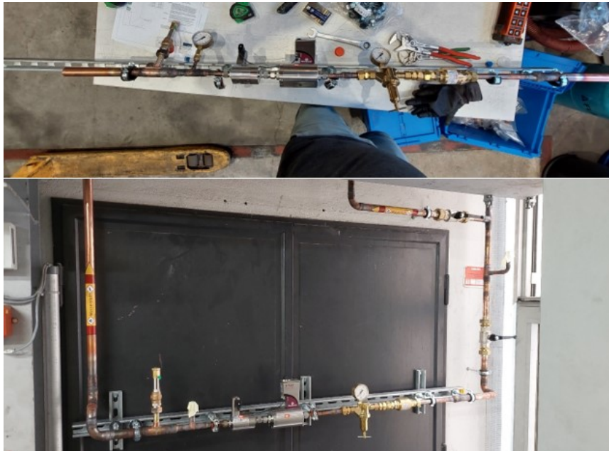
Abbildung 25: Komplette Regelstrecke beim zusammenbauen (oben) und fertig montiert (unten)
