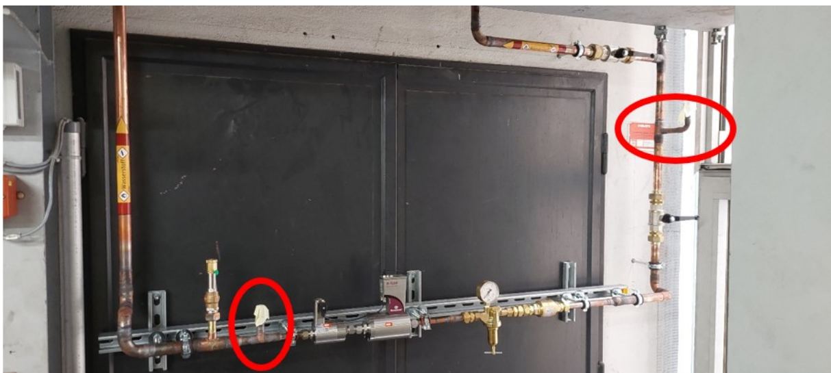
Abbildung 30: Druckmessstellen vor und nach der Regelstrecke
