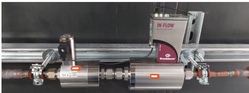
Abbildung 28: Eingebauter Mass Flow Controller in der Wasserstoffregelstrecke
