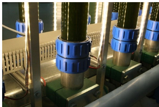
Abbildung 14 – Installation von LED-Bändern zur künstlichen Beleuchtung
