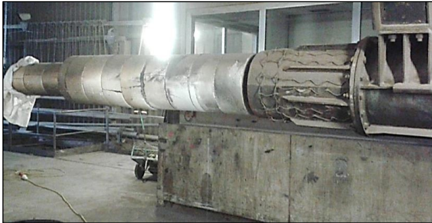
Abbildung 5-9: Erdgasbrennerlanze mit feuerfester Ummantelung zur Befuerung des Langdrehrohrrofens DO3 [70]
