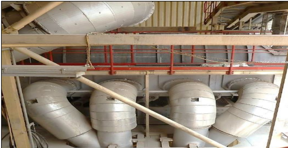
Abbildung 5-14: Ansicht des Fließbettvorwärmers [70]
