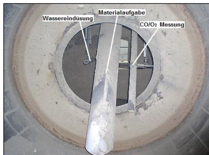
Abbildung 5-8: Ofeneinlauf des Langdrehrohrföfens DO3 (Breitenau) [70]
