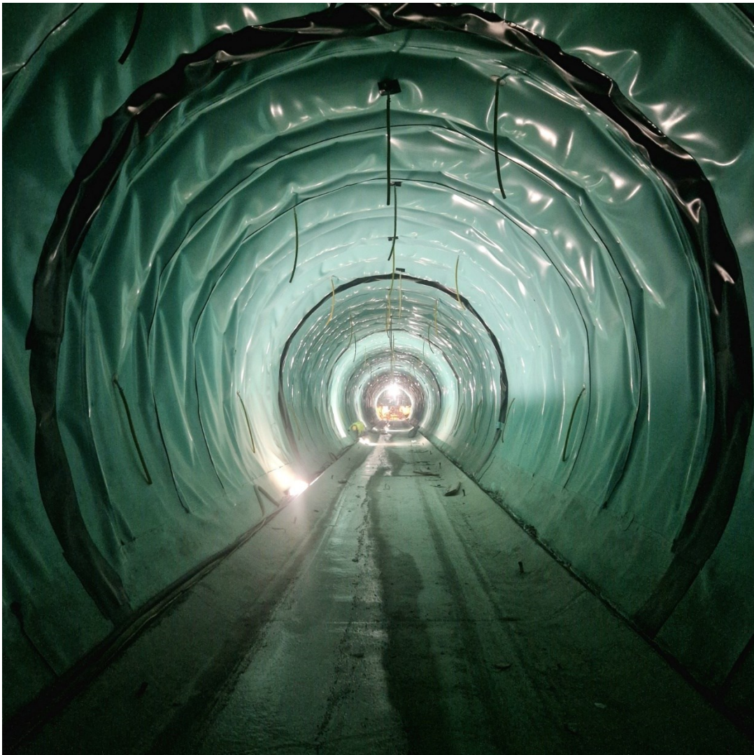
Abbildung 2 - Abdichtung im Kraftabstieg KWTM (Foto: Lukas Stift)
