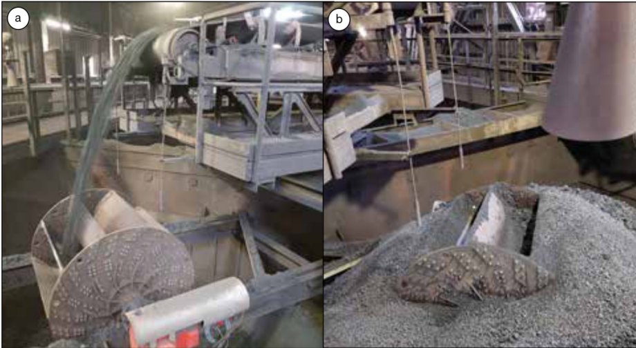
Bild 14: Durchströmturbine a) im Betrieb mit 5 U/min b) überschüttet
