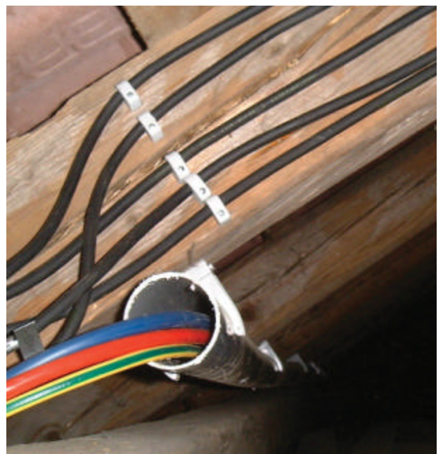
Bild 8-5 DC-Kabelführung in Oberputzrohren
