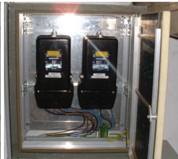
Bild 7-16 Analysezähler im Geräteschuppen
