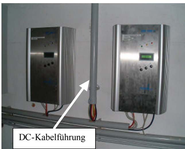
Bild 8-6 DC-Kabelführung zu den WR
