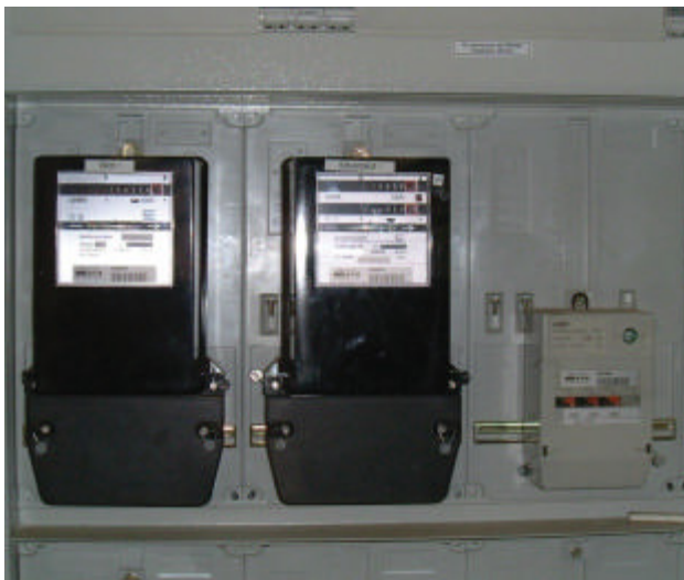
Bild 7-15 Bezugs- und Rücklaufzähler im Wohnhaus
