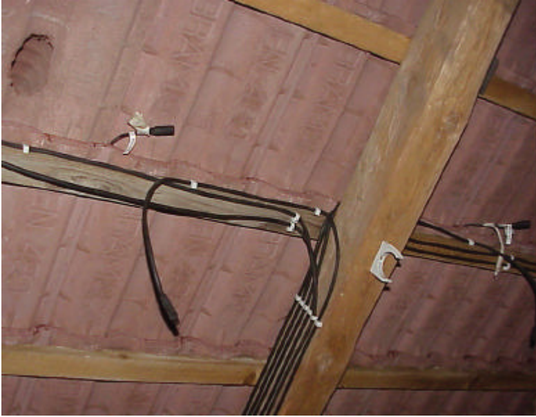
Bild 8-2 Stringkabelführung im Dachinneren
