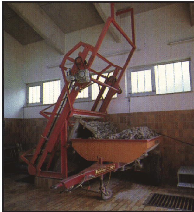
Rechen im Zulauf
