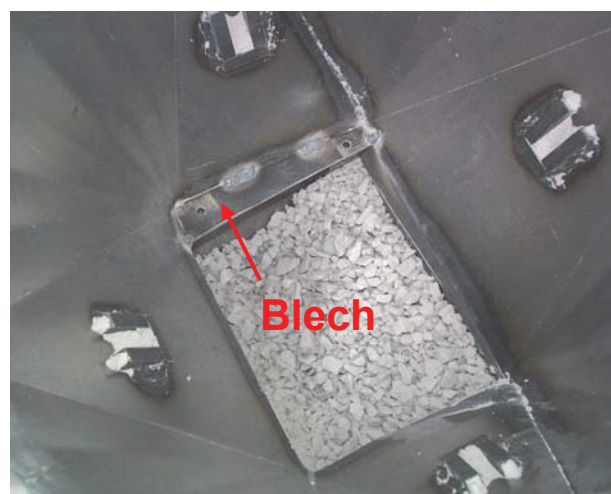
Abbildung 54: Austragsöffnung mit aufgeschweißtem Blech
