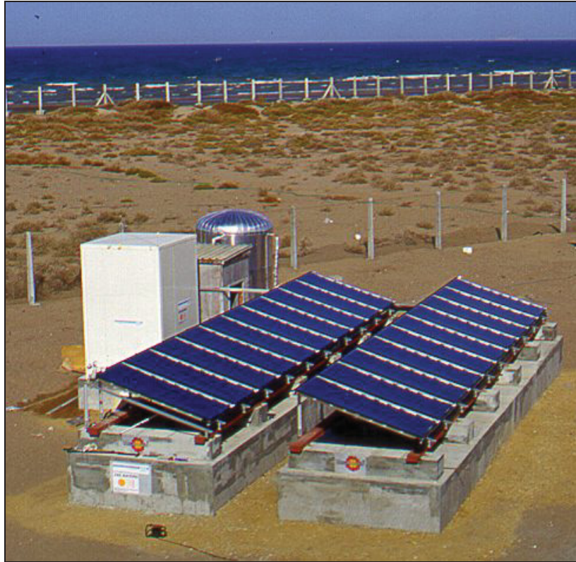
Abbildung 31: Außenansicht der Meerwasserentsalzungsanlage im Oman (MÜLLER-HOLST/SCHÖLKOPF, o.J.).
