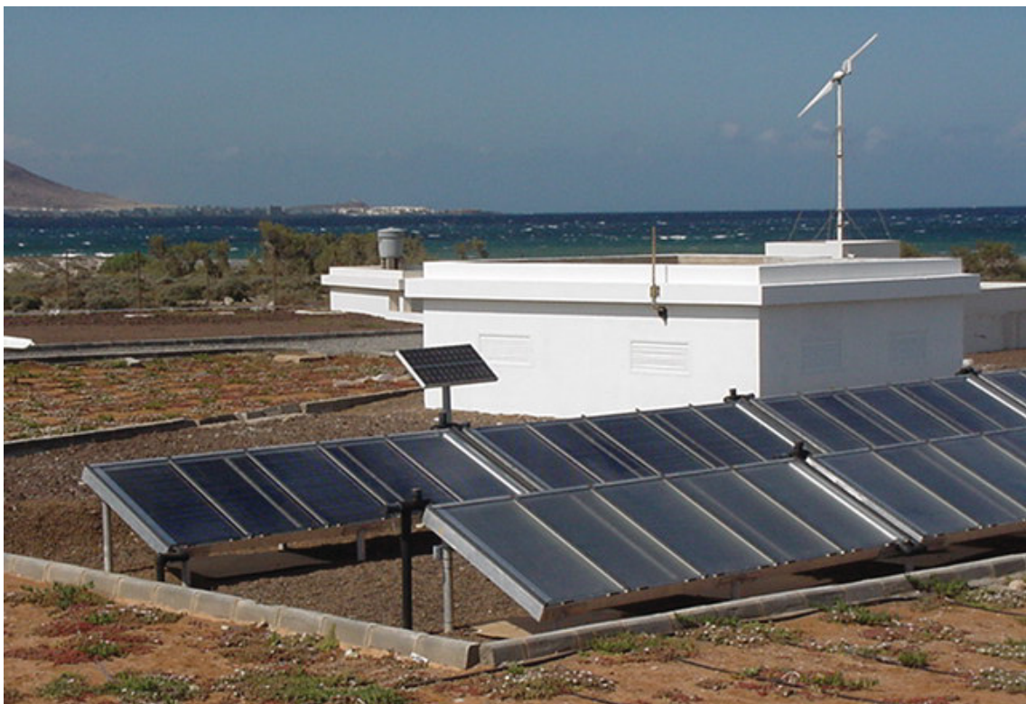
Abbildung 30: Außenansicht der Meerwasserentsalzungsanlage Pozo Izquierdo, Gran Canaria, SODESA (MÜLLER-HOLST/SCHÖLKOPF, o.J.).
