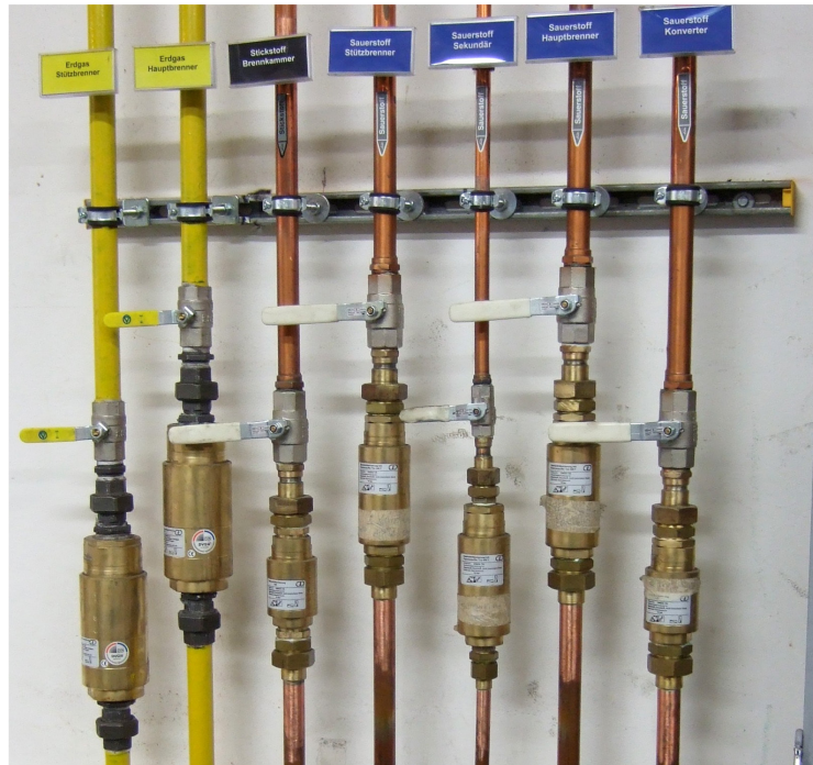
Gasversorgungsleitungen für Erdgas, Sauerstoff und Stickstoff in der Nähe des Hauptburners im OG des Technikums mit händisch bedienbaren Absperrrichtungen sowie Gas- und Flammenrücktrittsicherungen [32] [123]
