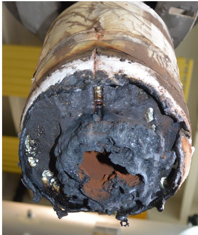
Abbildung 21: Zerstörter Brennerkopf der Kampagne 09
