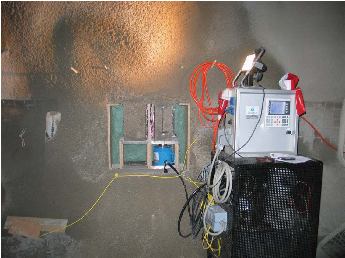
Abb. 35.: eingebaute In-Situ Druckversuchsanlage
