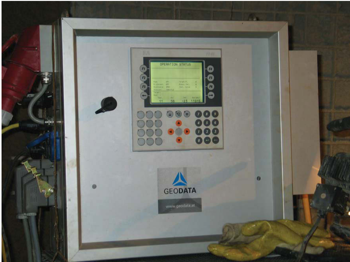
Abb. 26.: Bedienungsoberfläche der Programmier- und Datenspeichereinheit
