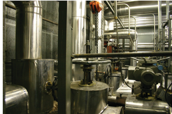
Abbildung 16: Sicherheitsventile der Abgangsleitungen
