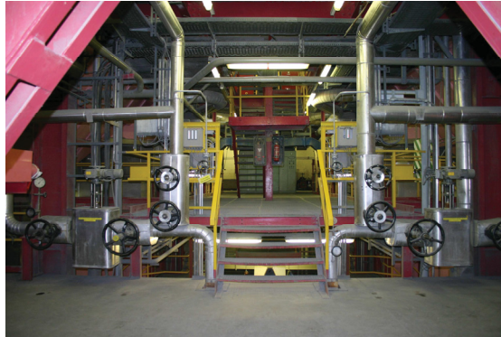
Abbildung 9: Speiswasserregelstation der beiden Müllkessel
