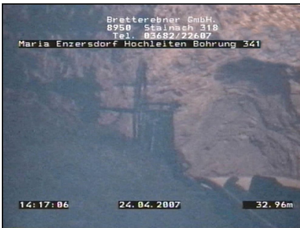
Abb. 31: BL 341; Alte handbetriebene Wasserpumpe
