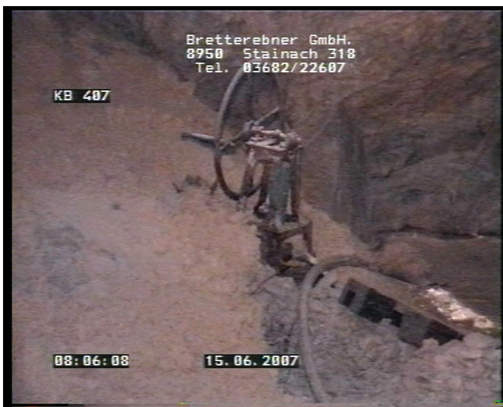
Abb. 45: Alte händisch betriebene Wasserpumpe
