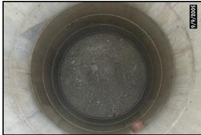
Abb. 10: Versickerungsschacht auf 845/6 KG Maria Enzersdorf [vgl. Lit.8, S. 7]
