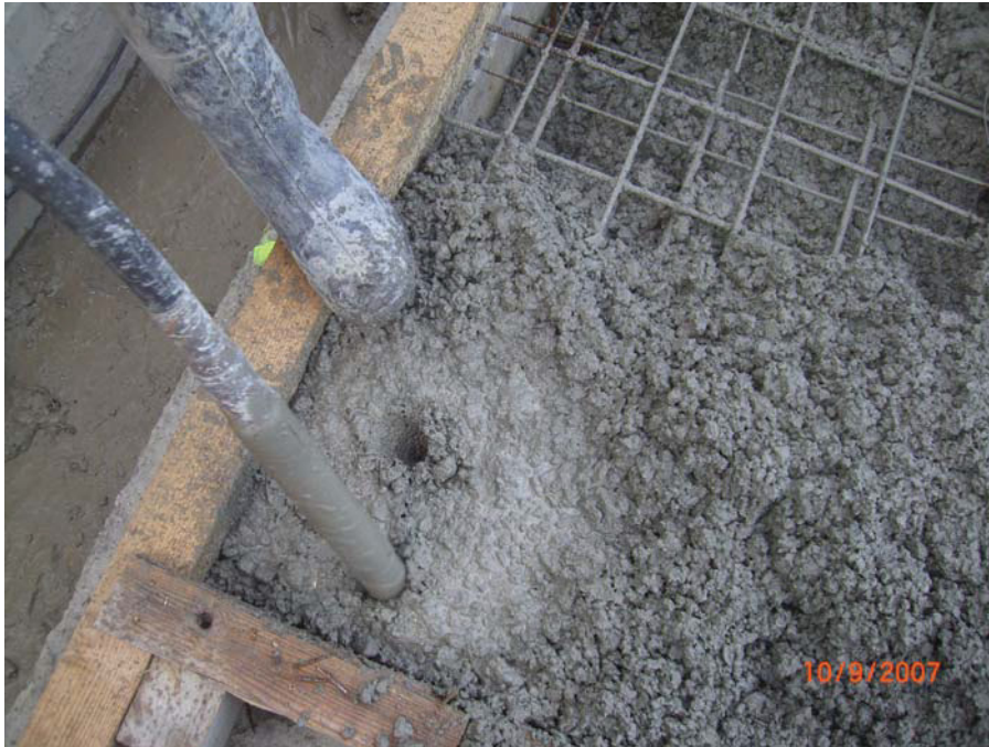
Abbildung 49: Betonplatte mit Loch des Rüttlers
