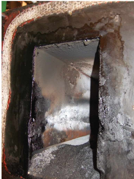
Abbildung 9.7: Brennkammer nach Betrieb der Anlage mit vier 4,2mm Bohrungen in der Rückwand
