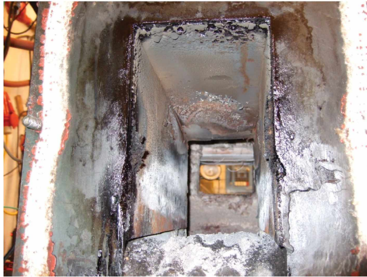
Abbildung 9.4: Situation in der Brennkammer nach Abstellen der Anlage mit vier 4,2 mm Bohrungen in der Rückwand
