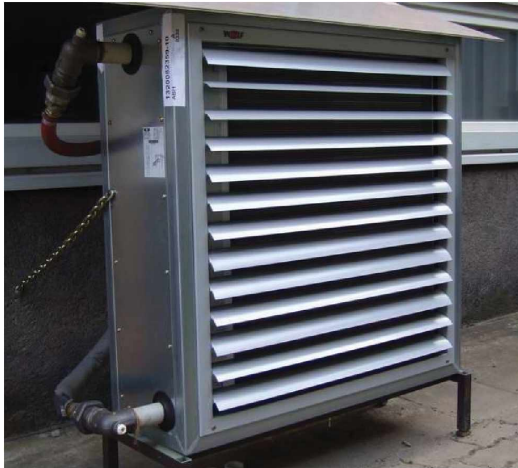
Abbildung 6.9: Luftheizer außerhalb des Versuchsraumes [20]
