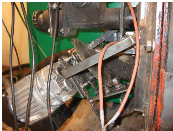
Abbildung 6.6: Antrieb des Verbrennungsrostes
