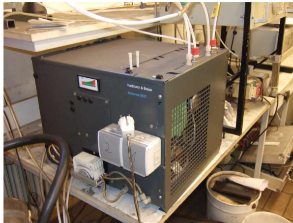
Abbildung 6.12: Messgaskühler Hartmann & Braun, Advance SCC
