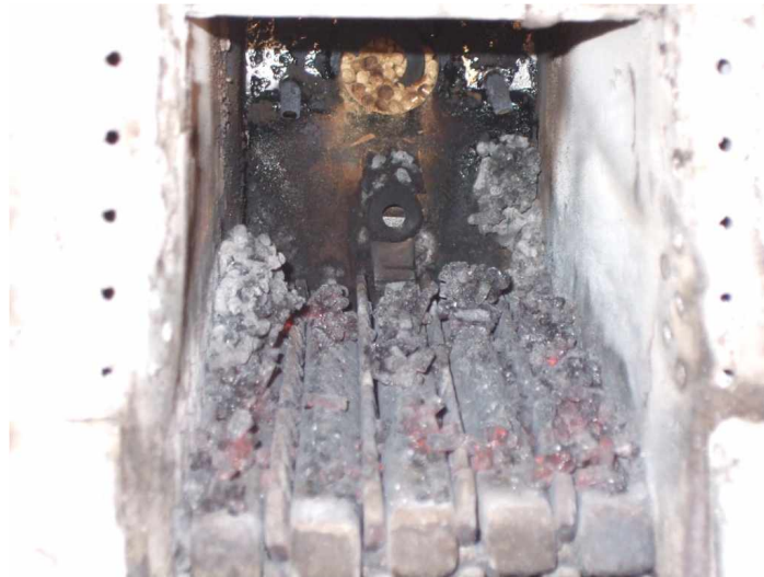
Abbildung 9.15: Situation nach dem Abstellen der Anlage nach Einbau der kurzen Düsen
