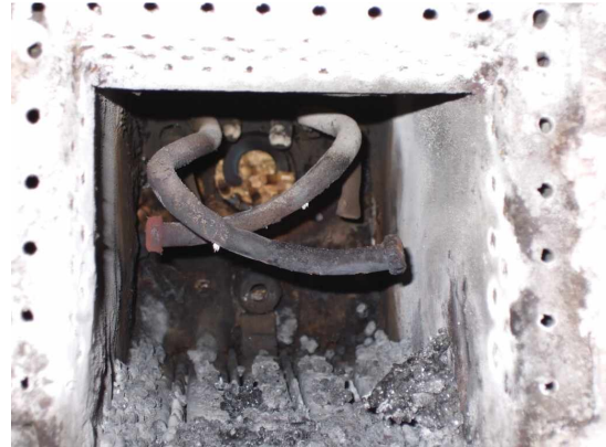
Abbildung 9.17: Situation im Brennstoffeintragsbereich bei der Letztversion der Primärluftführung - keine Versottungen, keine Verkrustungen auf den Roststäben
