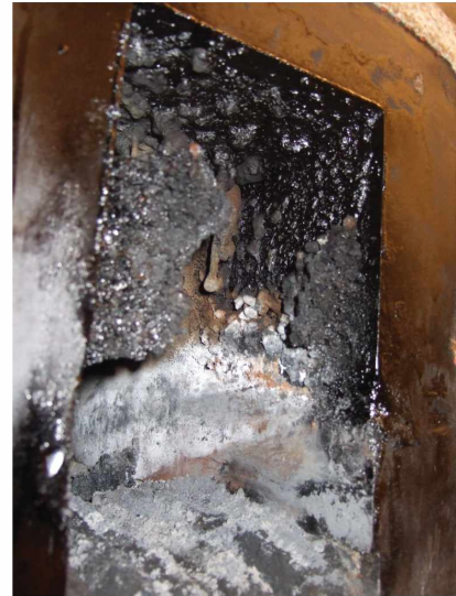
Abbildung 9.2: Brennkammerwände beim Brennstoffeintrag nach Änderung der Luftführung von unten (1,7 m/s primär)
