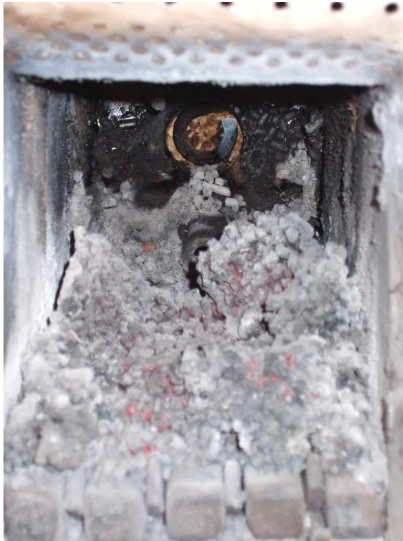
Abbildung 9.1: Rost und Brennkammer nach Veränderung der Luftführung von unten (1,7 m/s primär)
