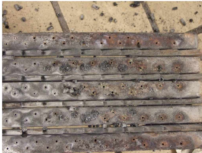
Abbildung 9.9: Lokale blasenförmige Verkrustungen rund um einzelne Rostlöcher
