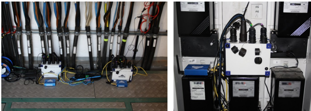
Abbildung 4-3: Messaufbau innerhalb der Trafostation (links) und im Inneren des Verteilerkastens (rechts)
