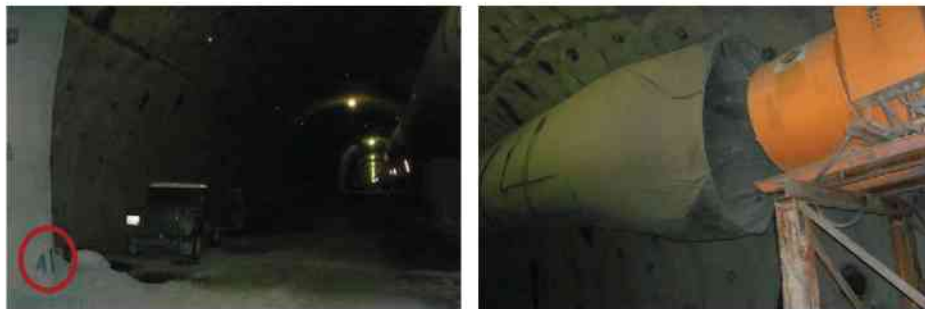
Abb. 5-8: BBT: Messung der Beleuchtungsstärke: Lage MP 1, 300 m von der Ortsbrust entfernt
