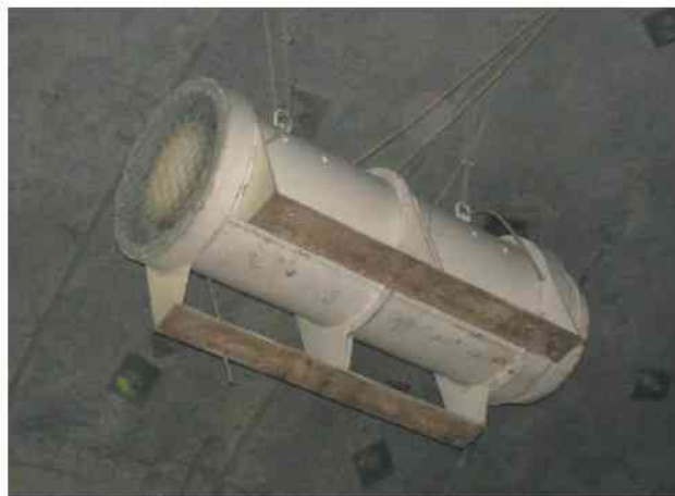
Abb. 5-16: BBT: Bereich Lutten-Verlängerung: zusätzlicher Ventilator
