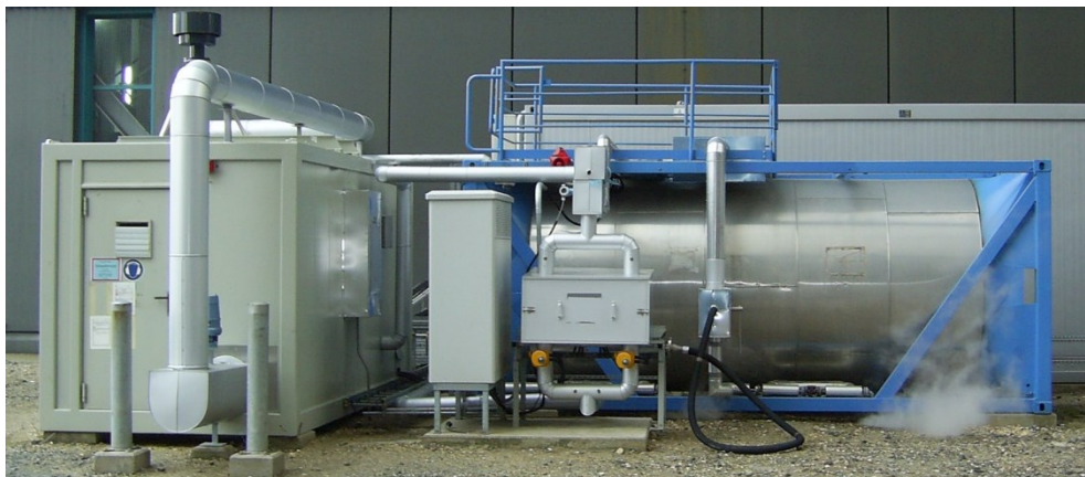
Abbildung 32: Aufstellung Rauchgaskonditionierung (Fa. PENTOL)
