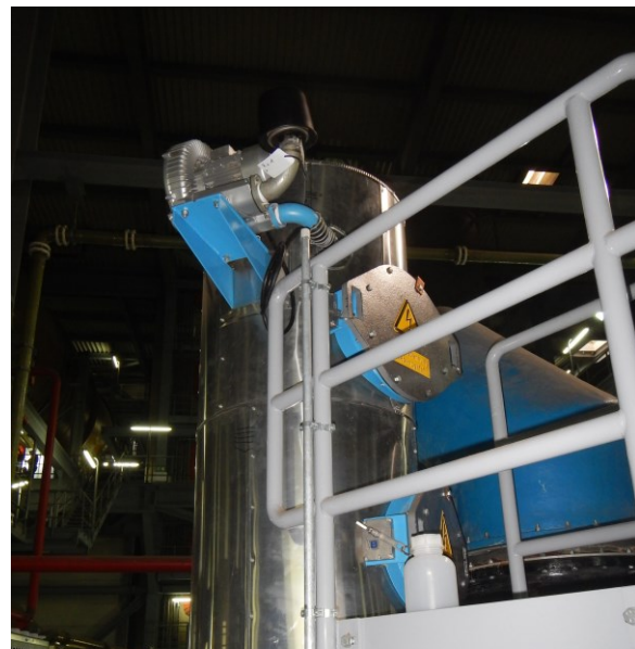
Abbildung 29: Isolator mit Sperrluftventilator
