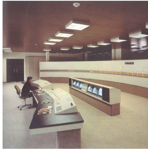
Abbildung III-20: Tunnelwarte des Arlberg Tunnels (1978) [3]
