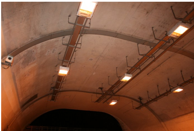
Abbildung III-11: Hochdruck Entladungslampen im Einfahrtsbereich
