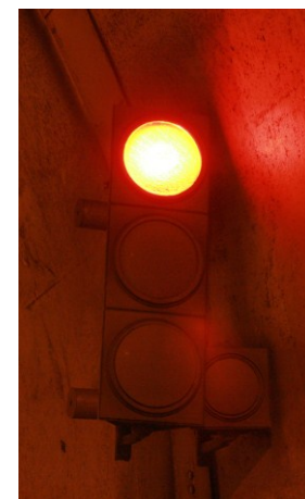
Abbildung III-15: Lichtsignalanlage im Tunnel
