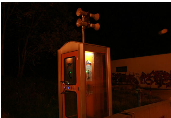
Abbildung III-23: Notrufstation, Hydrant und Beschallungsanlage im Vorportalbereich
