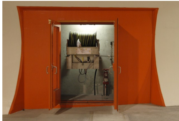
Abbildung III-12: Feuerlöschnische mit Schlauchhaspel [53]
