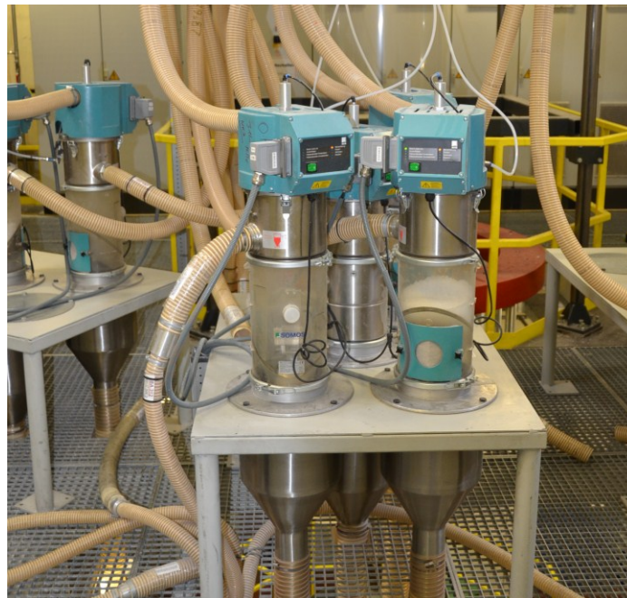
Abbildung 27: Druchluftfördereinrichtung mit Lagerbehälter
