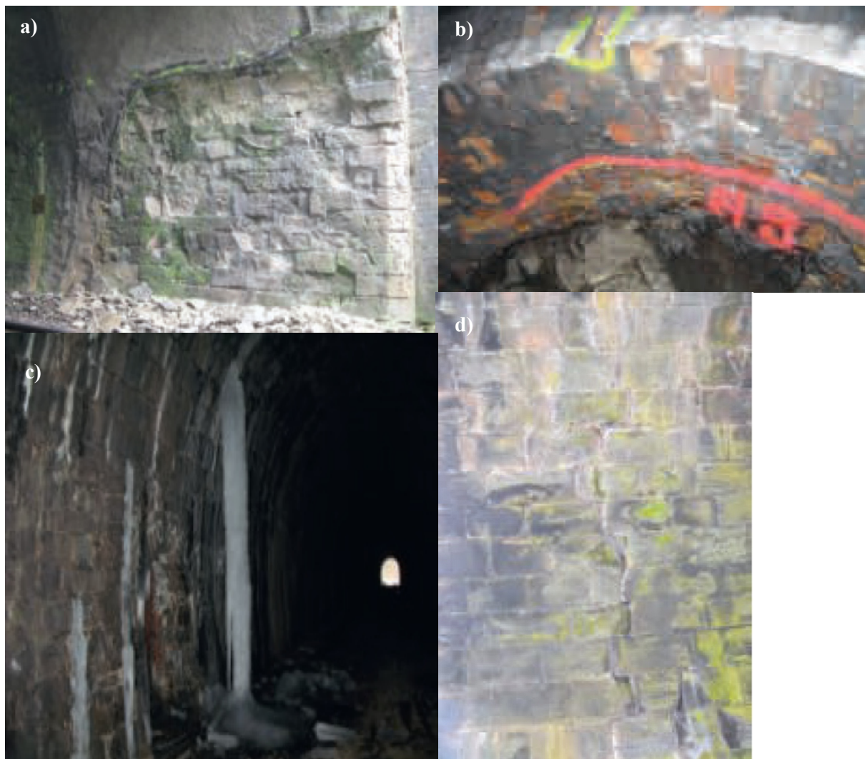
Abbildung 33: Schadensbilder im Modelltunnel. a) Abschalung, Abplatzung, Ausbruch von Spritzbeton. b) Abschalung, Abplatzung, Ausbruch von Natursteinmauerwerk. c) Eisbildung in den Portalbereichen. d) Risse in Mauerwerk. [44].
