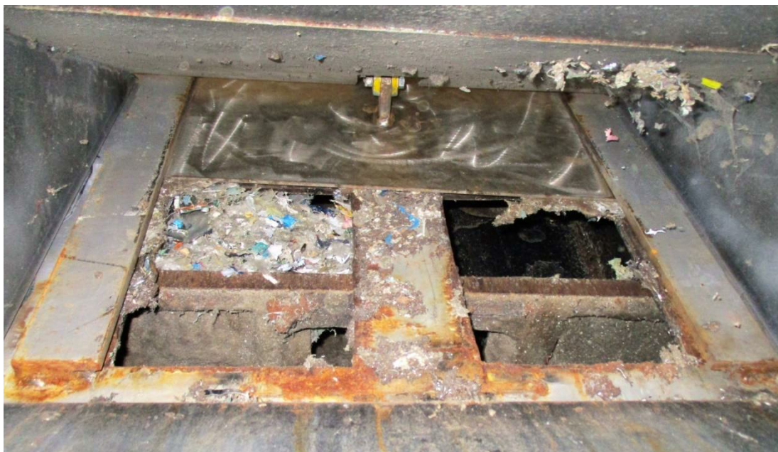
Abbildung 53: Probenahmeschleuse im offenen Zustand
