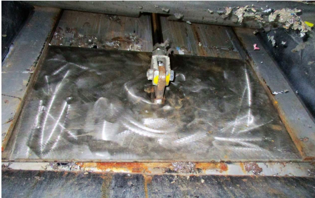
Abbildung 52: Probenahmeschleuse im geschlossenen Zustand
