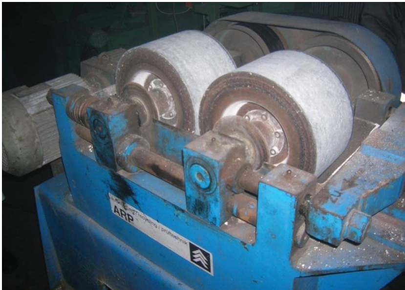
Abbildung 42: Walzenbrecher ohne Verkleidung und Aufgabetrichter
