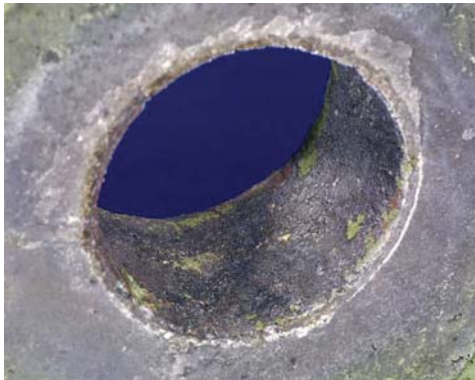
Abbildung 81: Plattenbohrloch nach dem Einsatz mit Gießkanalreinigung
