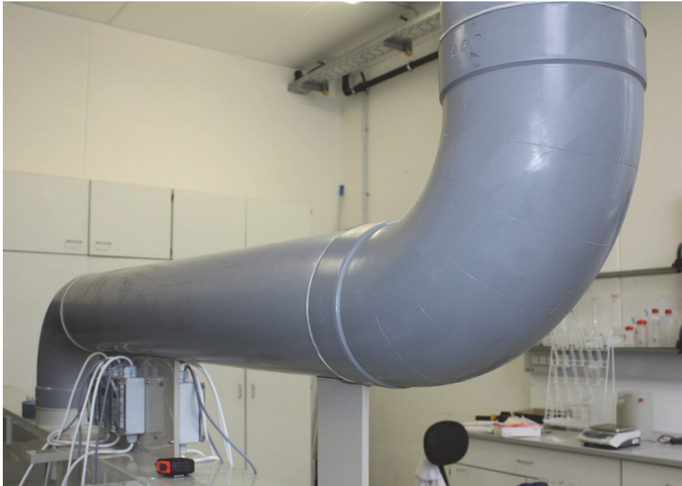
Abbildung 16-7: Anschluss der Absaugwand an das Laborbelüftungssystem
