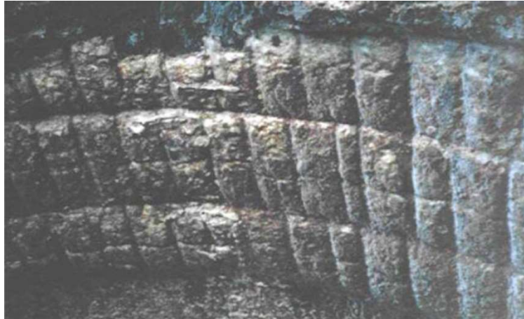
Abbildung 4: Durch Druckspannungen verursachtes Abplatzen an der Heißseite des Verschleißfutters führt zu ebenen Bruchflächen, die in weiterer Folge durch Erosion abgerundet werden und den sichtbaren Vorverschleiß in den Fugen hervorrufen können [9].
